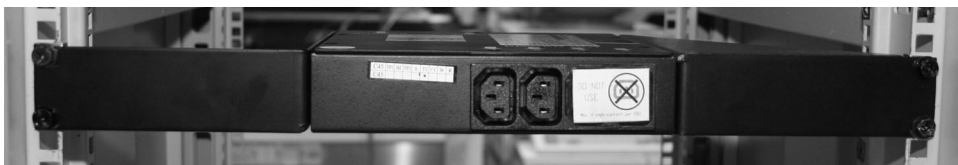
Figura 7. Posicionadas no Rack
