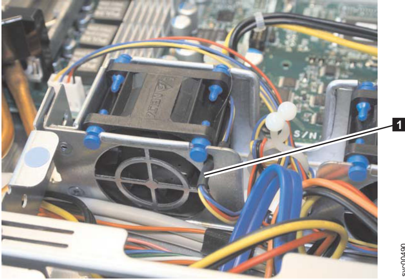
図 248. SAN ボリューム・コントローラー 2145-8A4 ファン・ケーブルの配線
